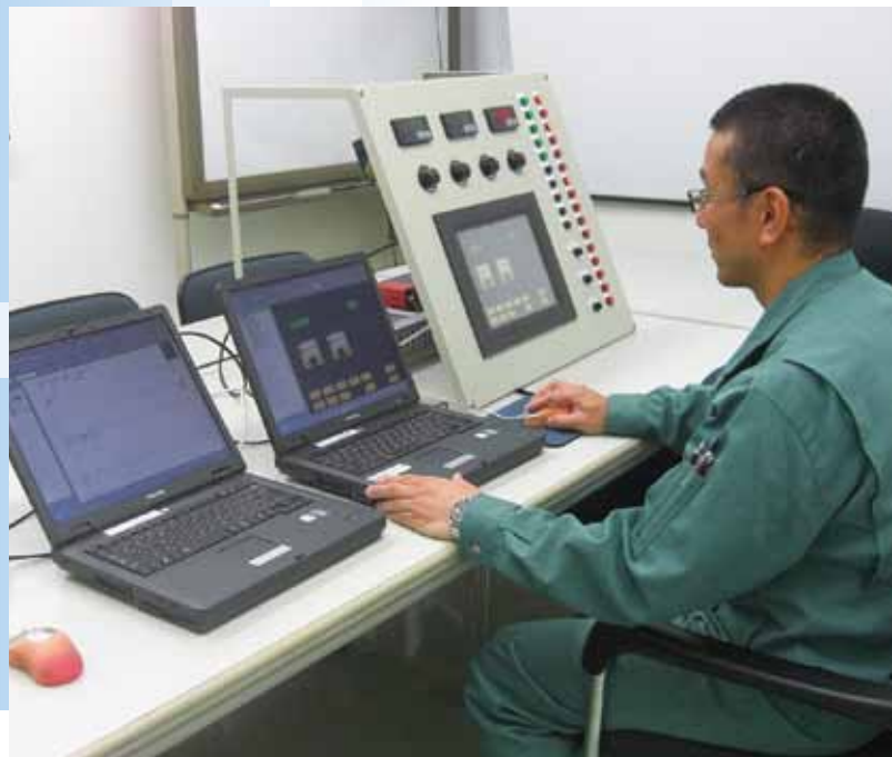
PLCタッチパネルシステムの構築
