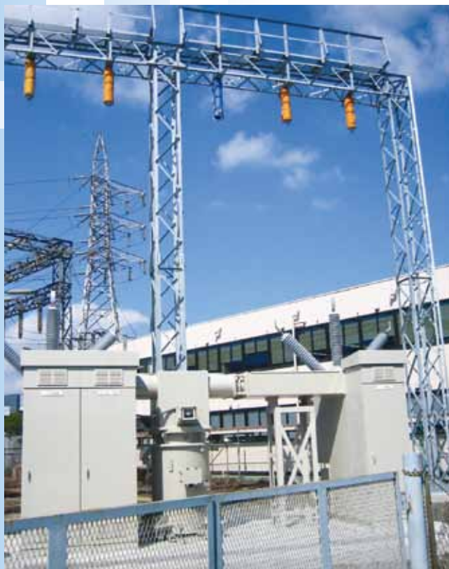
特高圧受電設備
