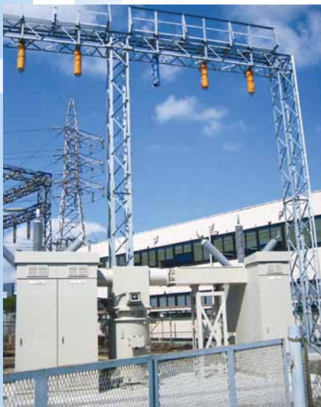
特高圧受電設備
